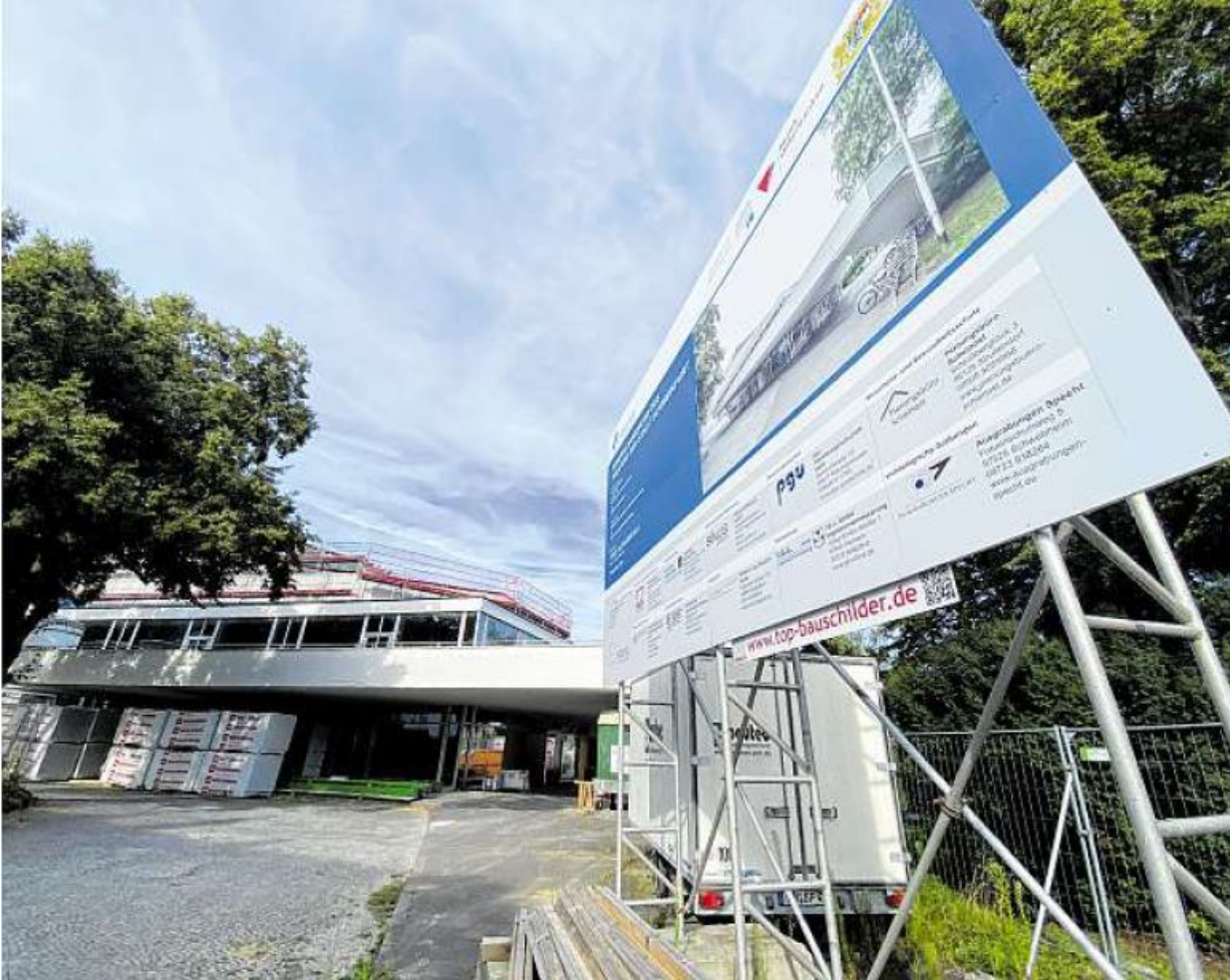
Das Theater in Schweinfurt wird derzeit saniert, die Wiedereröffnung des Haupthauses ist für Oktober 2027 geplant. Derzeit ist der Theaterbetrieb im Evangelischen Gemeindehaus. Fotos: Oliver Schikora
