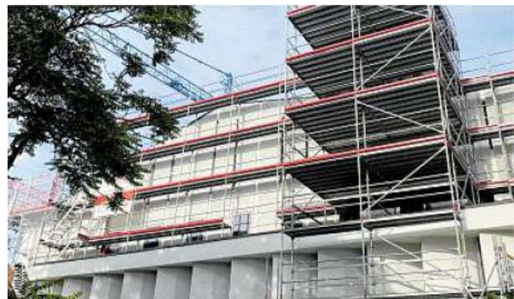
Das Gebäude ist vollständig eingerüstet, vor allem am markanten Kupferdach wird im Moment gearbeitet.
